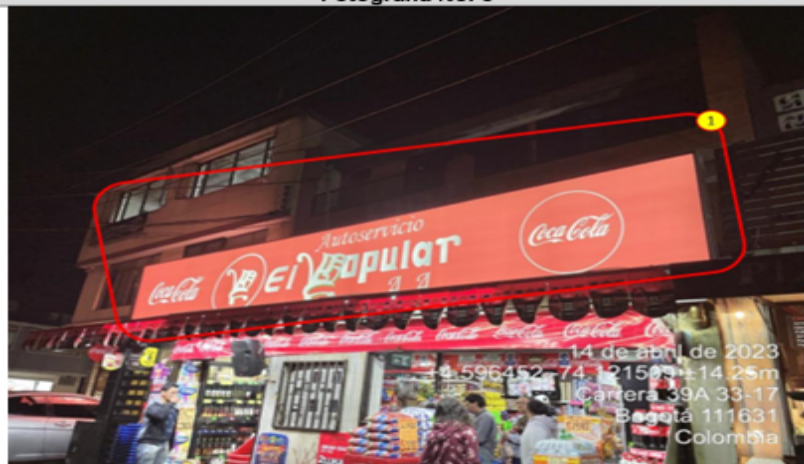
Elemento de PEV del establecimiento comercial, el cual se encuentra volado de la fachada de la edificación.
